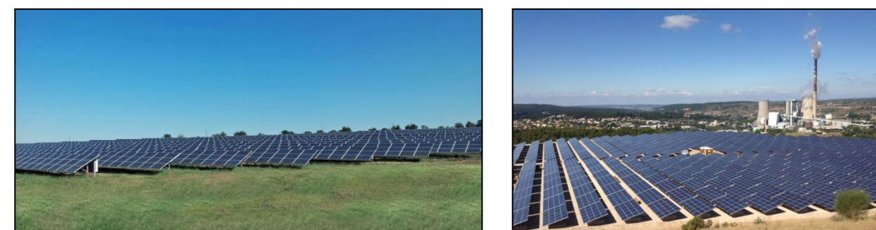
Réalisations Urbasolar : à gauche Granitec en Bulgarie. A droite, aménagement d'un ancien terroir à Gardanne (13) Source : URBASOLAR
